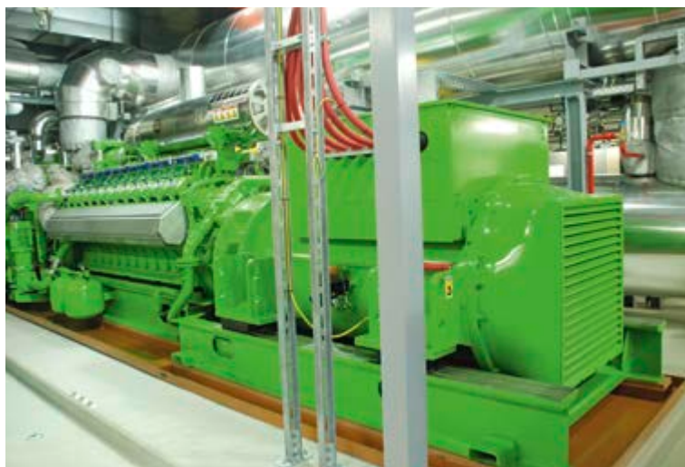
Ein hocheffizientes Blockheizkraftwerk produziert in Hamburg Strom für 4 500 Wohnungen und reduziert dabei den CO 2 -Ausstoß um 62 Prozent
